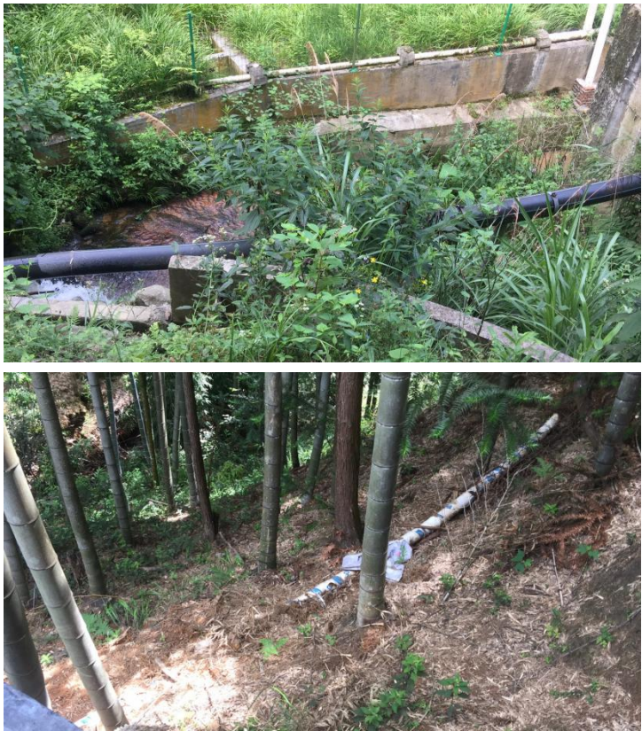
图 3.2-3 中村乡居阳村现状污水管道
